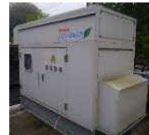
非常用発電機
